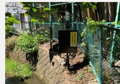
〔河川監視カメラの設置状況 (村山橋（奈良橋川））〕
