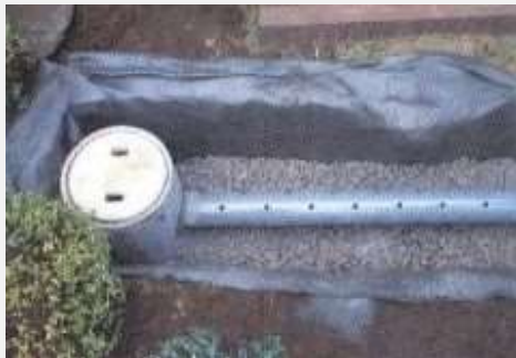
〔雨水浸透トレンチ〕
