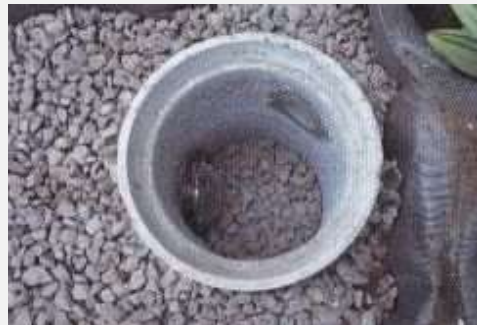
〔雨水浸透ます〕
