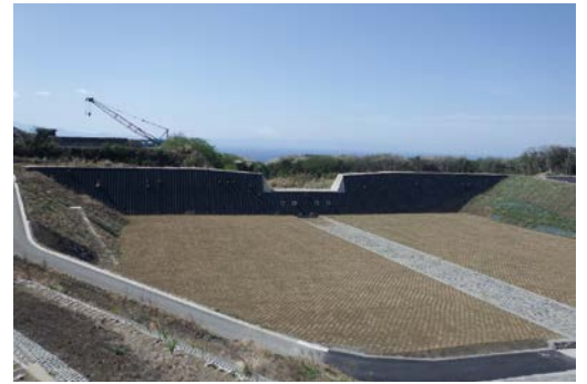
砂防施設(大島町)
