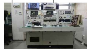
無線局無線設備
