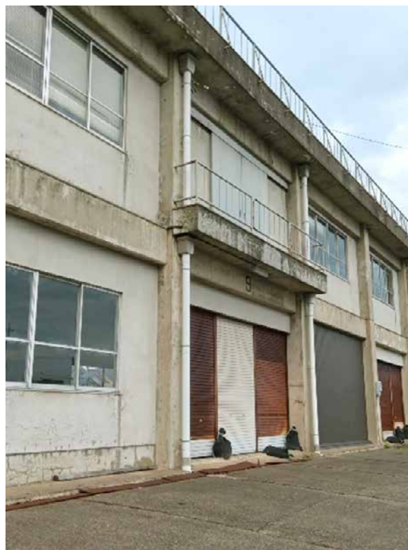
【氷見市間島・栄町地区】 （漁業関連施設。復旧が進んでいない。生業の復旧も急務。） （R7.10.07 阪井撮影）
