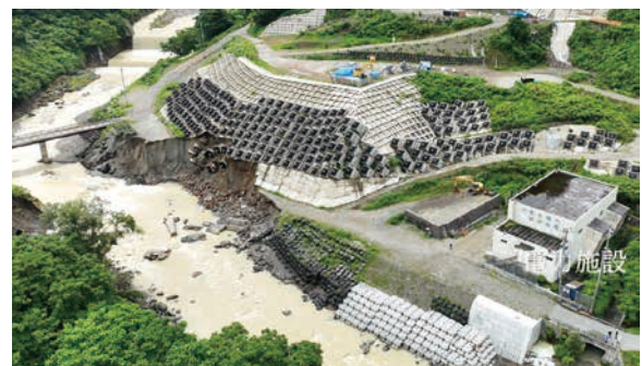
【対策中の大蔵村柳洲を襲う護岸崩壊】
