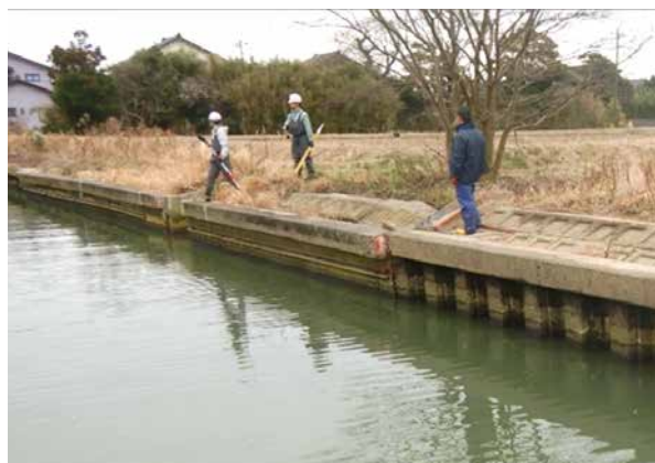
【鋼矢板(こうやいた)護岸の被災状況】
