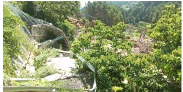
【地震災害の土砂崩れにより道路の形状が分からない状況】
