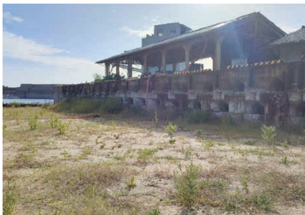
【鹿磯漁港（地震により4m近く隆起）】
