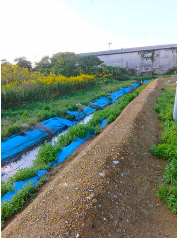
【高岡市吉久地区 農業用水路も被災】 （堤が崩落しているが、ブルーシートで補修、土盛りで応急措置） （R7.10.27 阪井撮影）
