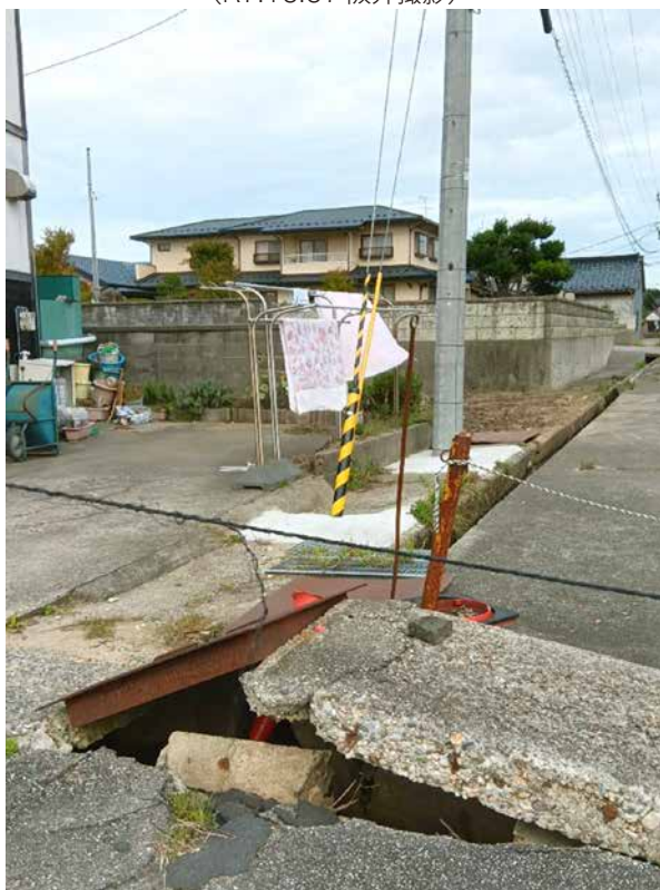
【氷見市間島・栄町地区】 （液状化で壊れた側溝。復旧が進んでいない。） （R7.10.07 阪井撮影）
