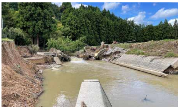
【担当する河川の被災状況】
