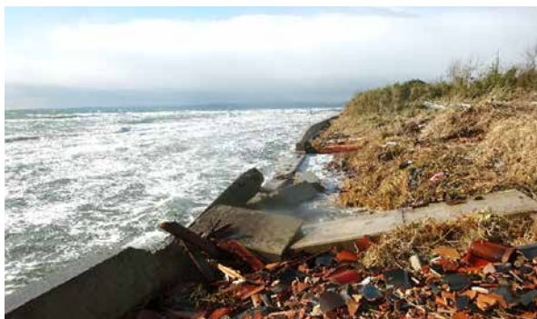
【海岸施設の被災状況】
