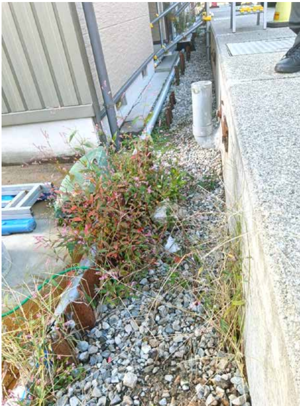
【高岡市吉久地区 液状化被害住宅】 （道路側が浮き上り、宅地側が沈下） （R7.10.27 阪井撮影）
