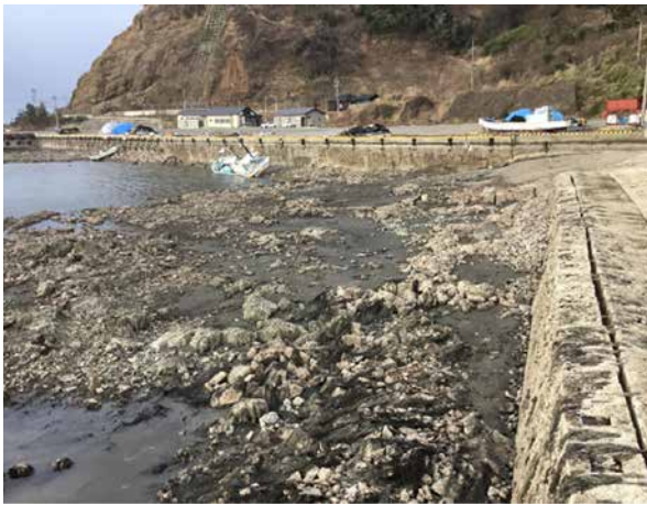
【応急復旧前（被災直後）】
