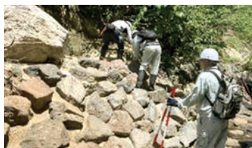
砂防施設の被災状況合同調査 (石川県)
