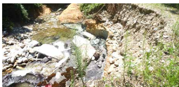
【護岸の倒壊状況（絵馬河川）】
