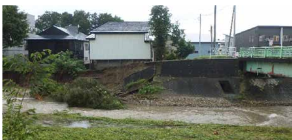
【護岸の倒壊状況（指首野川）】
