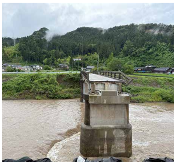
【奥能登豪雨で損傷した姫田橋】 （令和7年5月時点）
