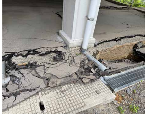
【施設の駐車場出入口は修繕未着手（令和7年6月七尾市）】
