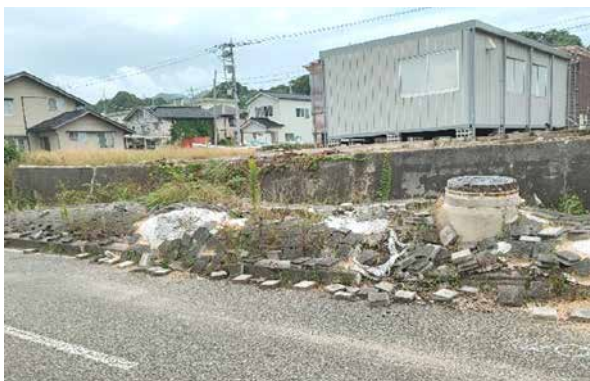
【輪島市街地（歩道 マンホール隆起）】
