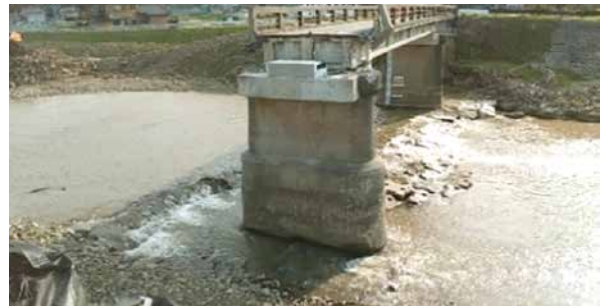
【豪雨災害で河川が氾濫し橋台と橋桁が流失】
