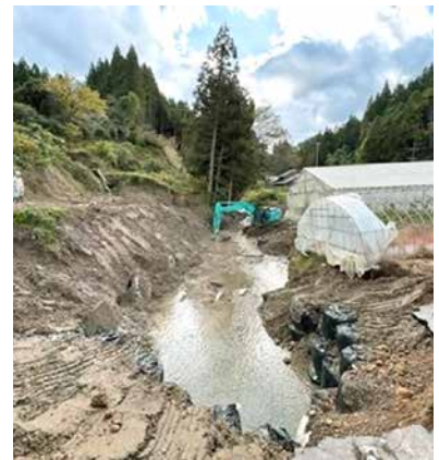
【大雨後（令和7年10月28日）】
