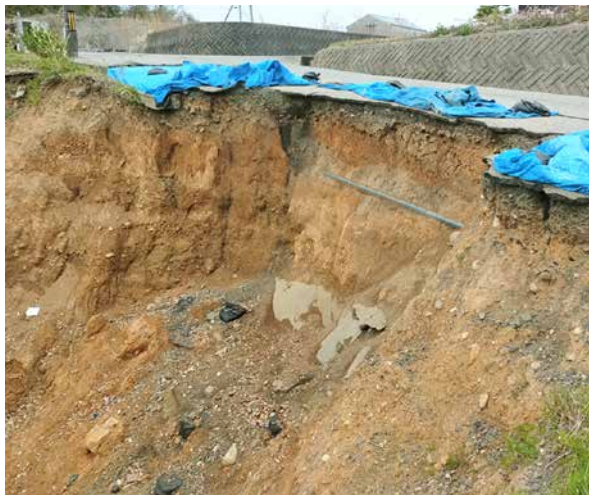
【道路が崩壊して露出した水道管】
