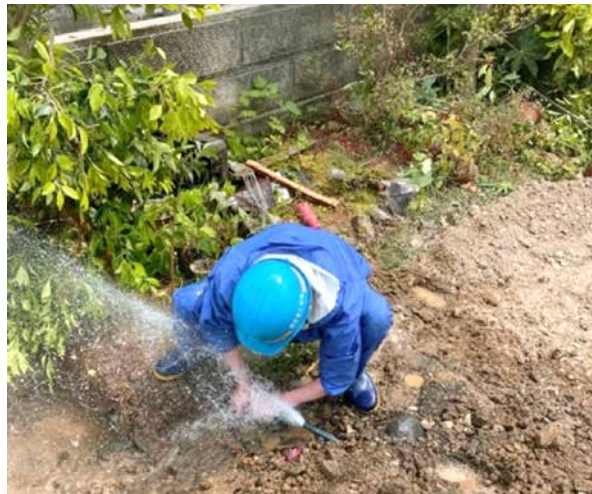
【破損した給水管の止水対応】
