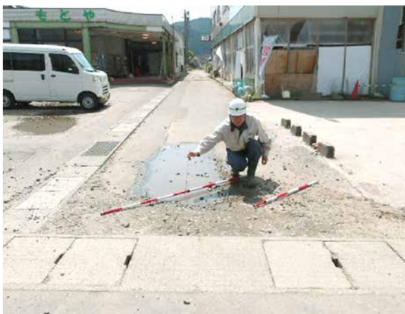
【被災根拠の調査（路面）】
