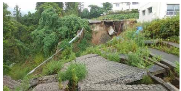
【地震災害による法面崩壊で道路が流失】
