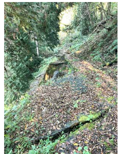
【三井地区内市道 手前路面崩壊及びその先のり面崩壊で通行不可、現場調査（令和7年11月6日撮影）】
