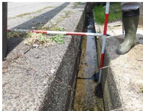
【被災根拠の調査（側溝）】
