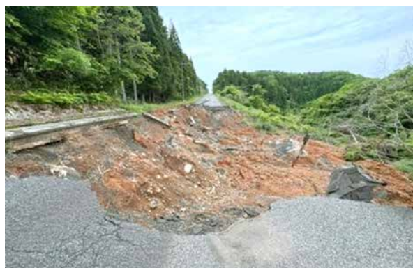
【地震により道路が崩壊】
