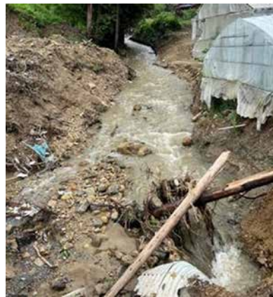
【大雨後（令和7年8月11日）】
