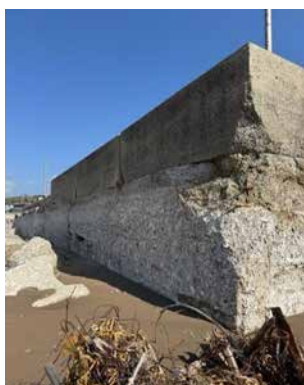
【地震により岸壁が隆起】
