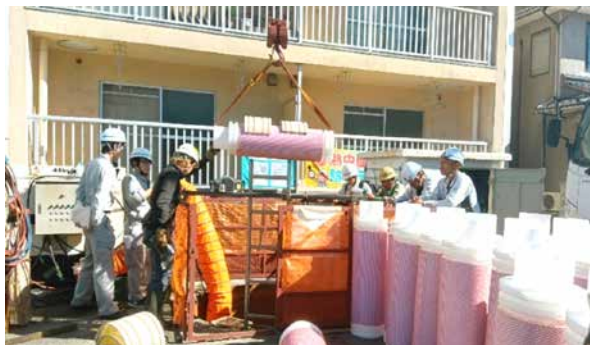
【射水市港地区】 （レジェンドパイプ工法における集水管（MPDパイプ）本体はポリプロピレン製でピンクの部分は網目状の補強材が巻かれています。）
