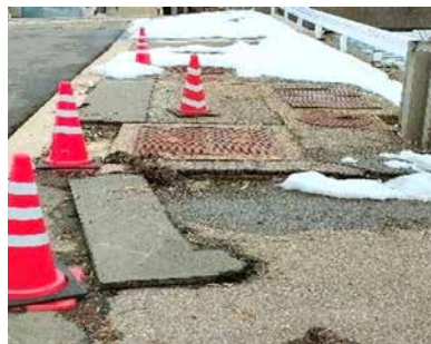
【舗装の損壊（R7年2月）】
