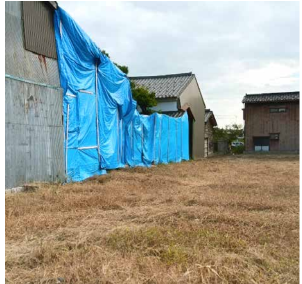
【氷見市間島・栄町地区】 (解体された建物と隔壁共有していた建物の壁をブルーシートで養生している) (R7.10.07 阪井撮影)
