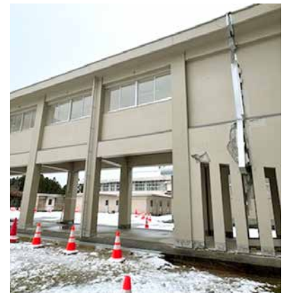
【破損したままの渡り廊下@珠洲市飯田高校】
