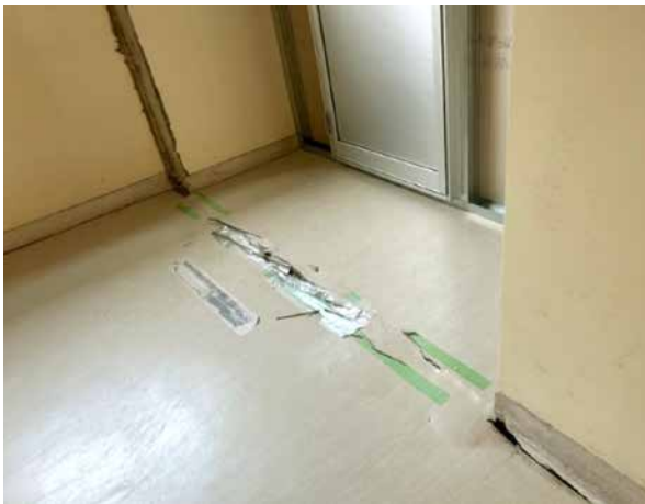
【飯田高校：廊下の床割れ被害状況】
