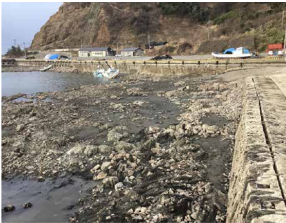
【応急復旧前（被災直後）】
