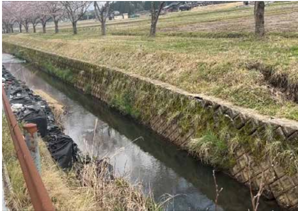
【ブロック護岸の被災状況】
