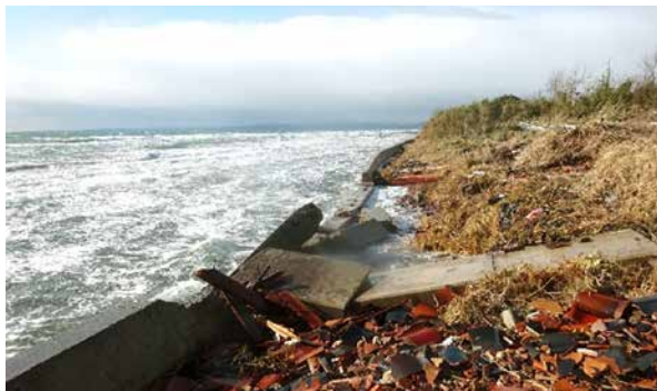
【海岸施設の被災状況】
