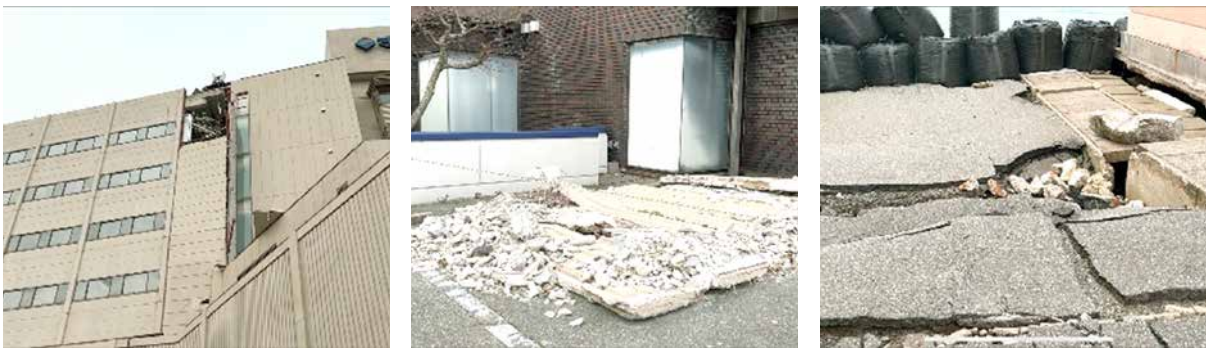
【温泉宿や道路の被災状況（七尾市和倉町）】
