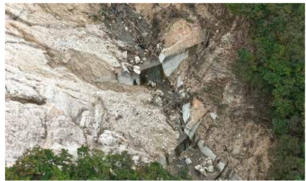
【砂防施設の被災状況】
