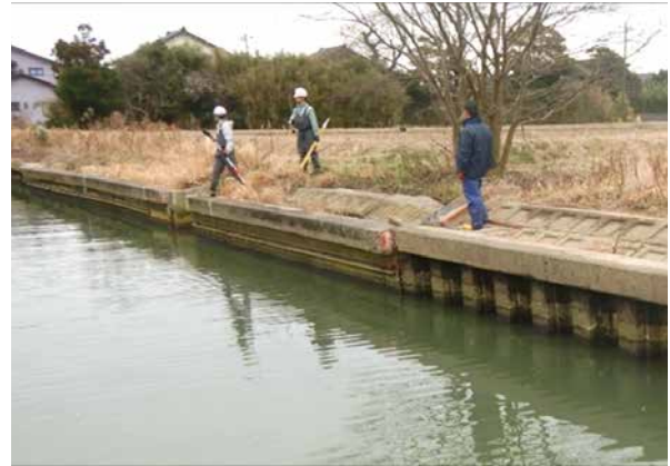
【鋼矢板(こうやいた)護岸の被災状況】
