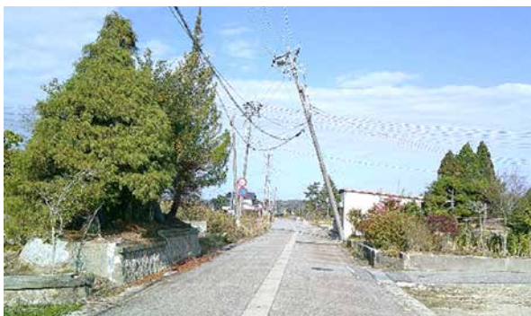
【地震で傾いた電柱】
