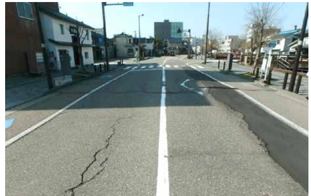
【七尾港線 クラック・段差発生状況（R6.3）】
