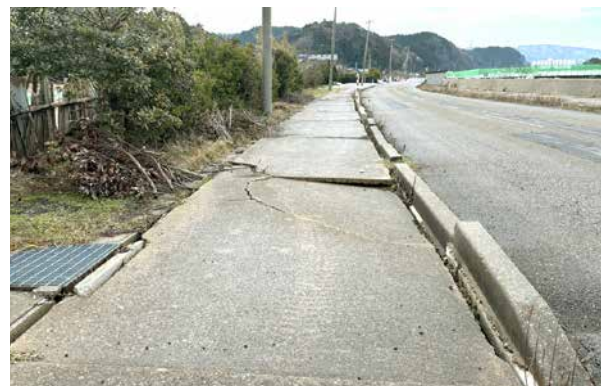
【歩道のひび割れ状況（七尾市内）】
