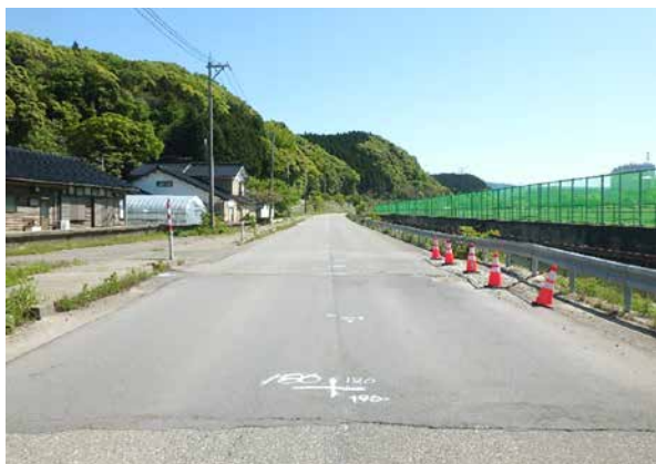
【舗装補修前 横断水路前後に段差が発生したため擦り付けられている R7.4】
