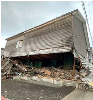
【未だ残る倒壊した家屋@輪島市（令和7年1月）】
