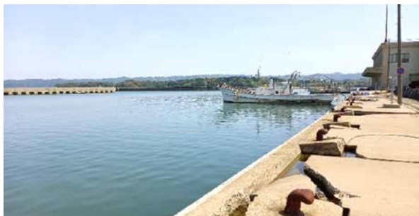
【岸壁が前面に傾斜し使用できない】
