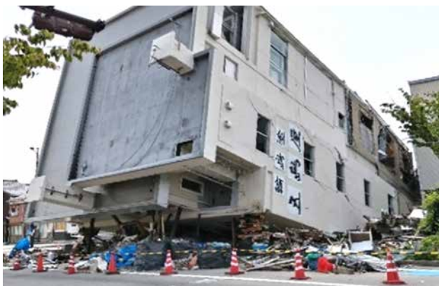
【地震で倒壊した輪島市内のビル】
