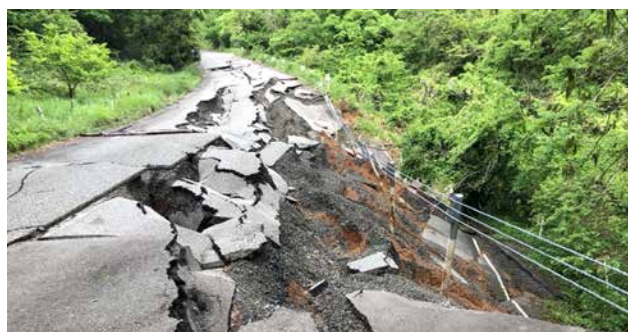
【輪島市における道路の被災状況（令和6年5月撮影）】
