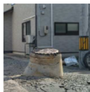
人孔浮上状況
