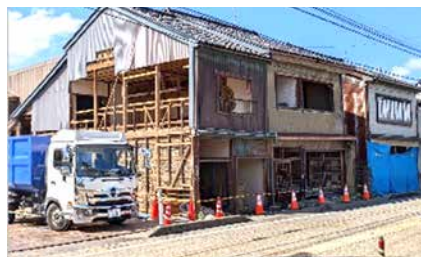
7.氷見市栄町地区被災状況
