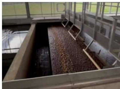
現場視察（溶存空気浮上装置）
