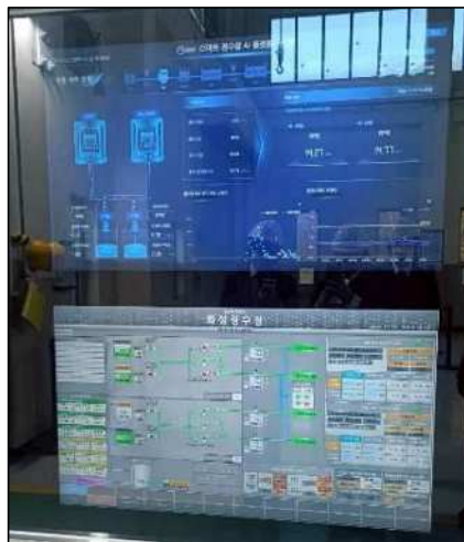
(上) A I による薬品注入予測画面 (下)薬品注入制御画面
