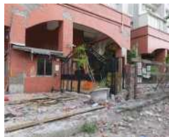
〈被災の痕跡が残る建物〉
