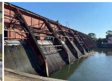
雨水ポンプ所ろ格機
