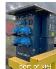
port of kiel 地上接続盤
