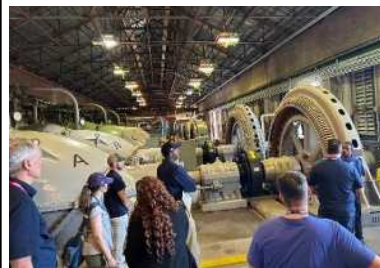
雨水ポンプ設備視察の様子
