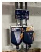
SCの充電設備
