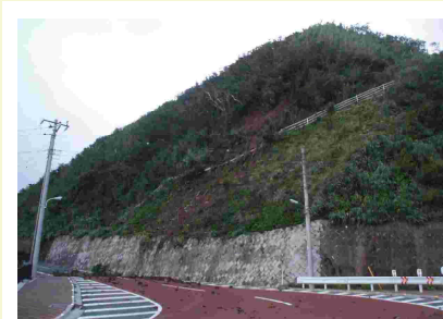
平成 22 年 10 月 30 日 台風 14 号による斜面崩壊
