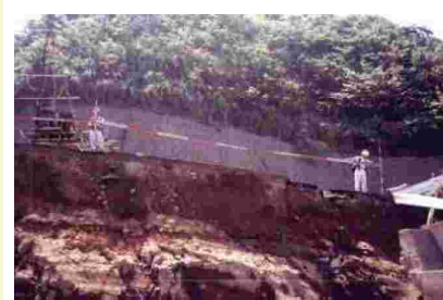
平成 12 年 路肩損壊
