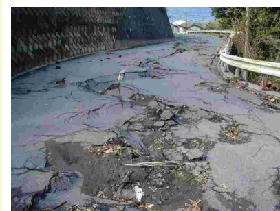
平成 12 年 路面損壊
