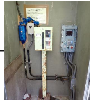
▶給油付帯設備
