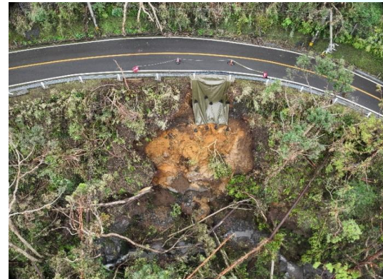
斜面崩壊(道路崩壊の恐れあり)
