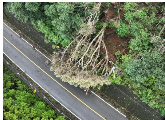
倒木(道路上に落下の恐れあり)
