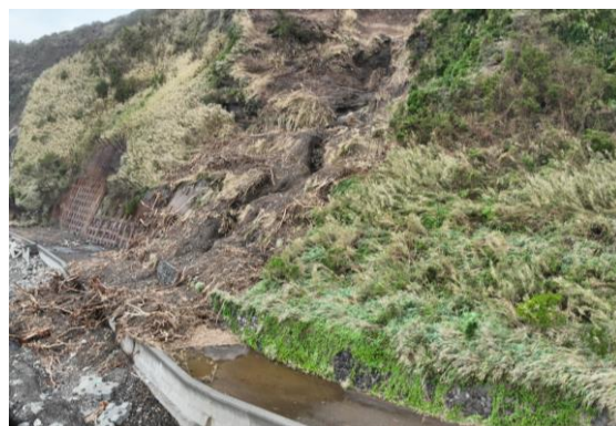
斜面崩壊(大規模)
