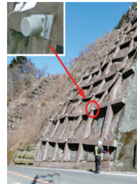
グラウンドアンカー
