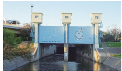
樋門（北多摩一号水再生センター）
