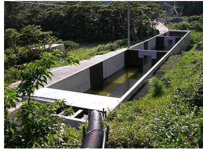
池之沢地区に整備された農業用貯水槽
