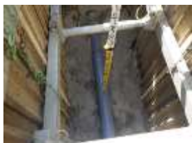
下水道管の整備状況
