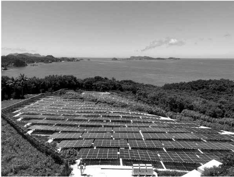
母島御幸之浜太陽光発電所
