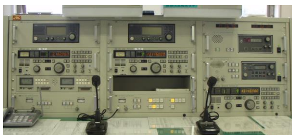
無線局舎通信室
