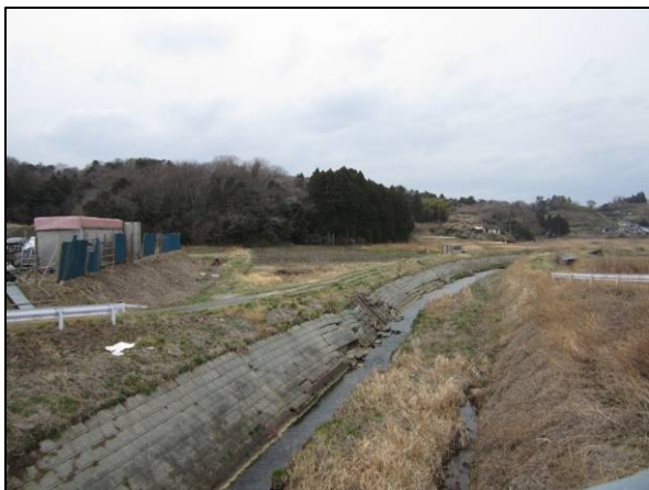
河川の被害現場
