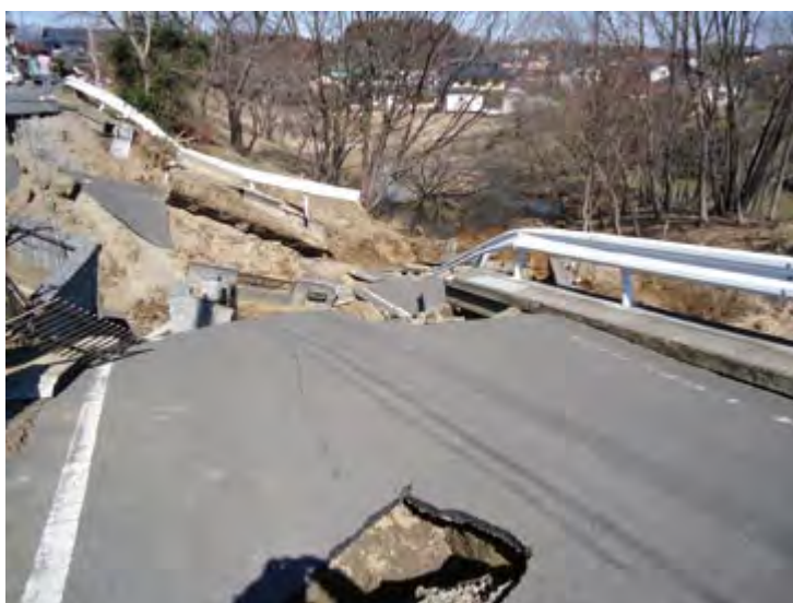
道路災 岡ノ内地区
