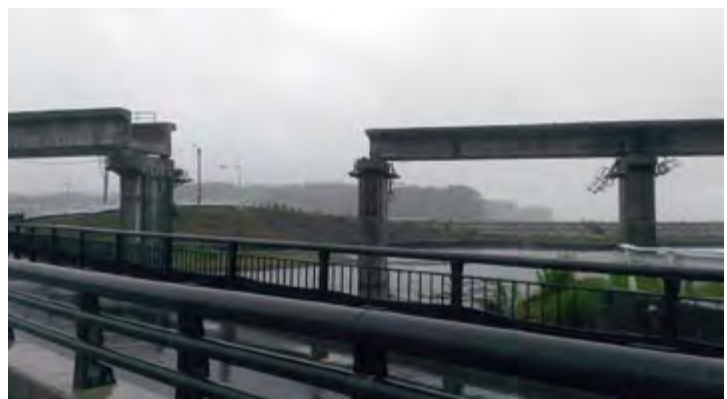
平成 25 年 7 月撮影 南三陸町 JR 気仙沼線の橋桁が流されている。
