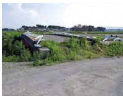
写真 2 被災した橋梁
