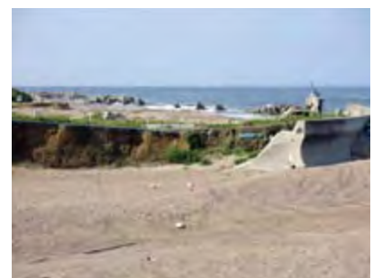
写真 3 破堤した海岸堤防
