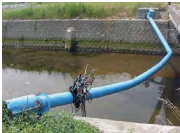
津波により損傷した水管橋（山田町）
