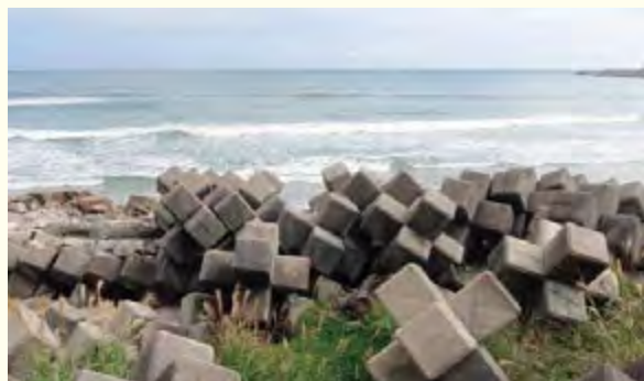
被災した防潮堤
