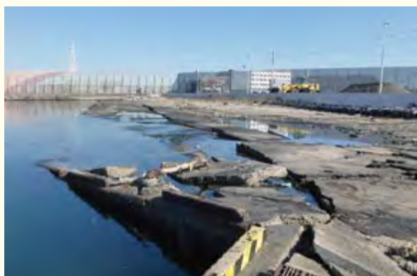
担当した物揚場。鋼矢板が変形し、倒壊している。
