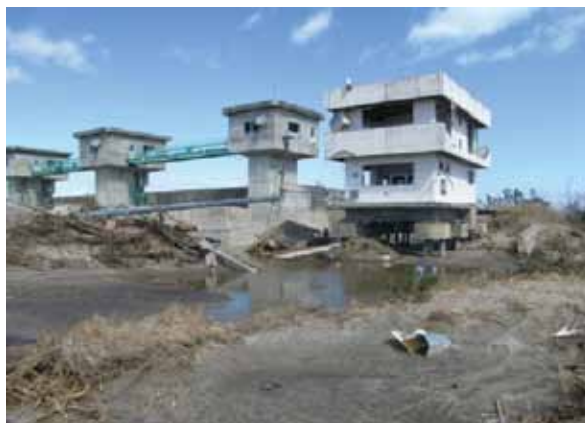
防潮水門の被災により背後地に甚大な被害が生じた。
