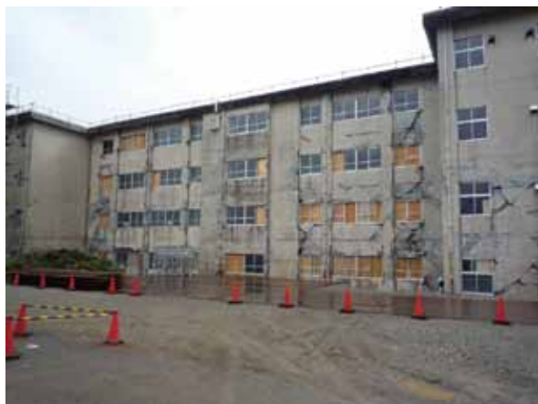
磐城農業高校旧校舎棟 被災状況 H23.3
