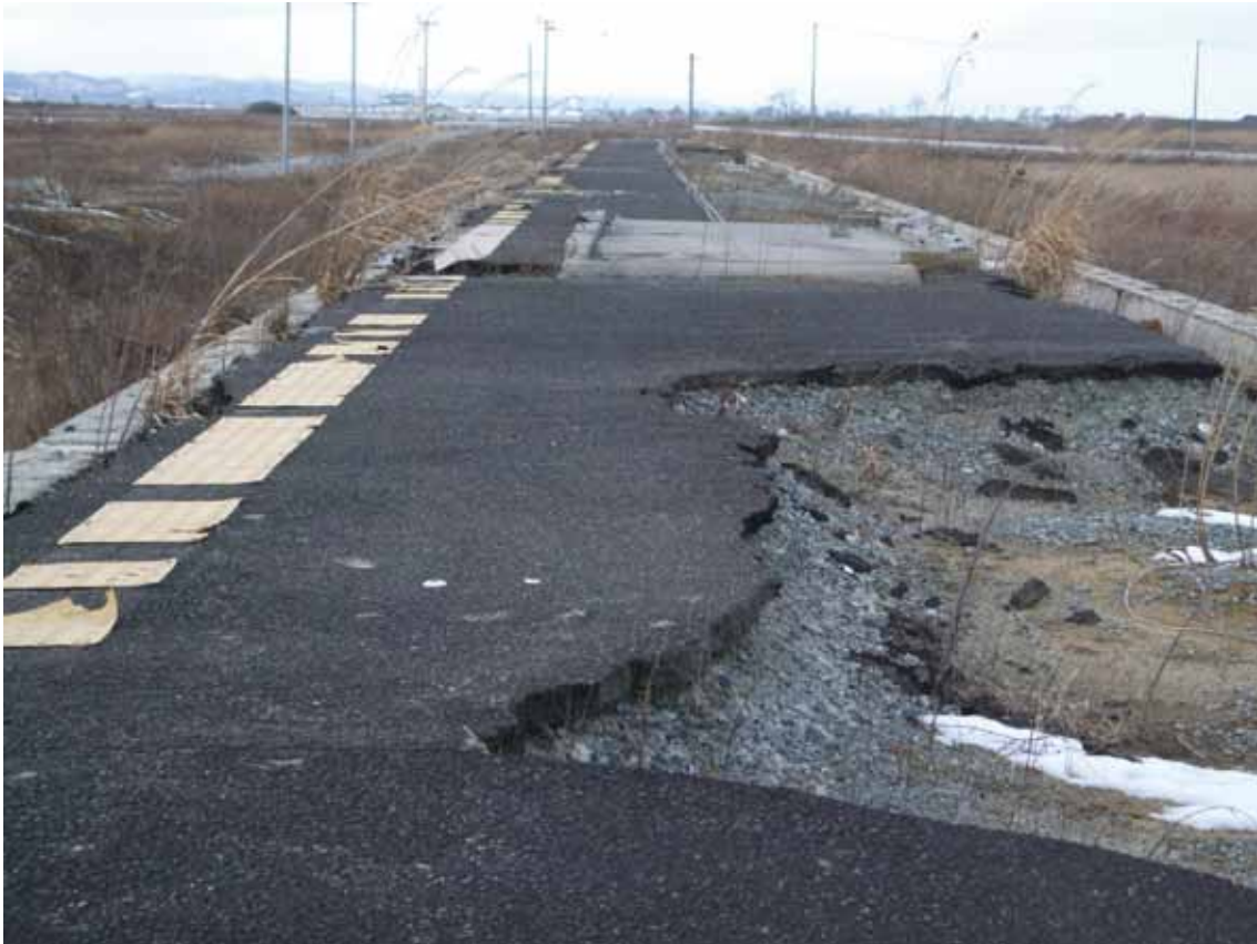
津波で被災したままの状態となっている旧JR常磐線坂元駅。現在は、内陸部に高架したJR新常磐線の工事が着工している。旧JR常磐線は今後、県道相馬亘理線となり仙台土木事務所用地買収後工事着手予定。
