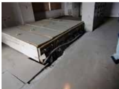
施設被災状況
