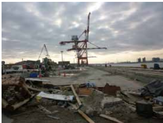
仙台港復旧前
