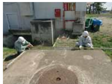
放流渠被災状況調査
