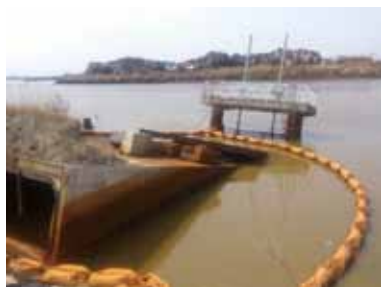
放流渠被災状況
