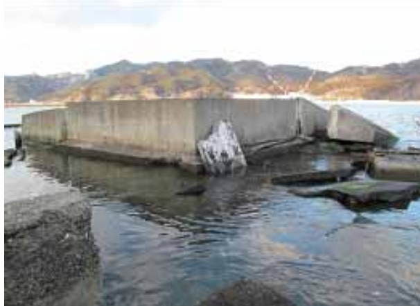
大槌町白石地区 現場付近の被害状況(2015年1月撮影) 陸地が地震により沈下し、海に沈んでいる様子
