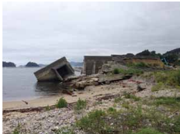
大津波により崩壊した防潮堤
