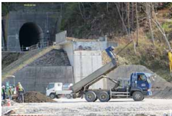
赴任直後(平成25年5月)に見た三陸鉄道・島越駅付近【田野畑村】津波により、線路ごと高架橋が流失していた。 ※ドラマ「あまちゃん」で、震災後の象徴的シーンで使われた場所
