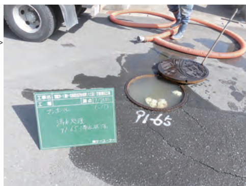
流れ切れない污水がマンホールから溢れ出ている模様
