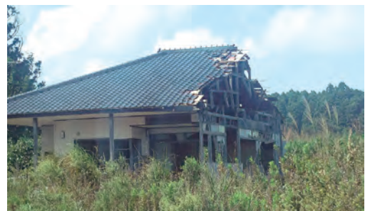
津波被害にあった家屋
