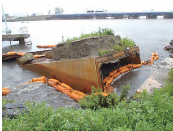
2013 年 7 月 18 日 釜排水ポンプ場放流渠 低気圧降雨による雨水排水状況 震災当時の被災状態での放流が続いている
