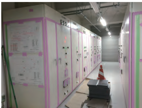
西庁舎の受変電設備
