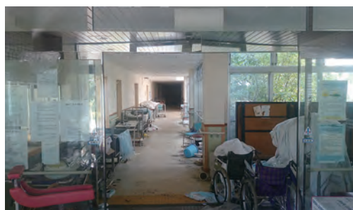
玄関。緊急避難の混乱からか備品が散乱している
