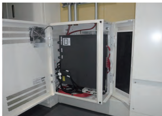
北庁舎の情報工事で設置した2スイッチ (WS-C3650-24TS-E)
