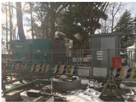
西庁舎の仮設非常用発電機
