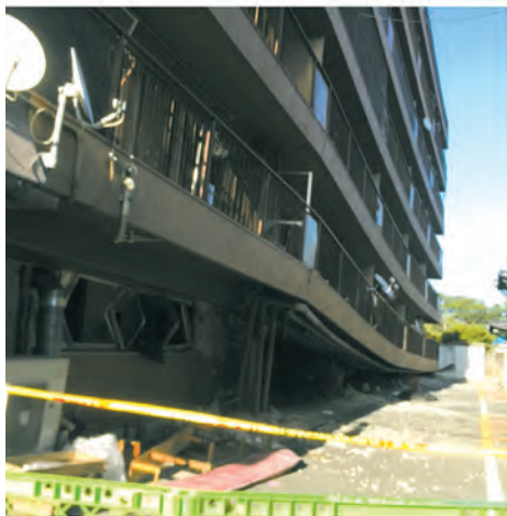
全壊の高層マンション
