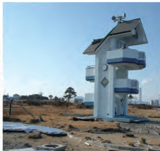
津波により被災
