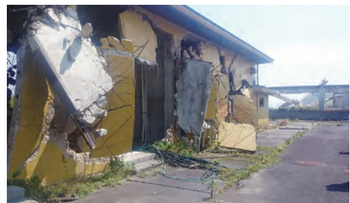
壁が鉄骨ごと変形している
