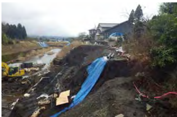
崩落した花原川の法面 (2018年9月撮影)
