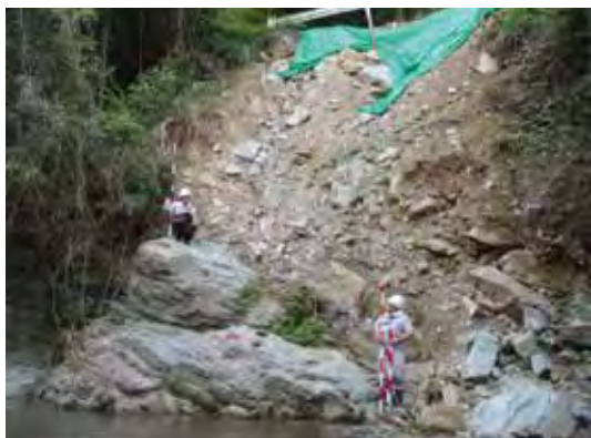
災害現場（矢落川）
