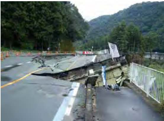
道路構造物の損壊
