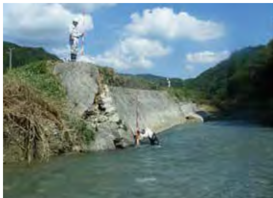
【護岸被災状況】
