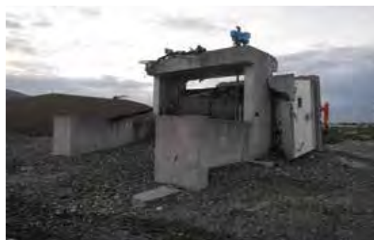
杉ノ下地区海岸の被災した樋門 (H30.10)
