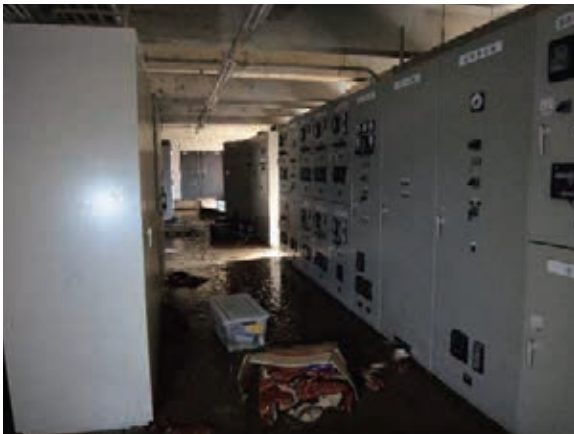
電気室（被災直後）
