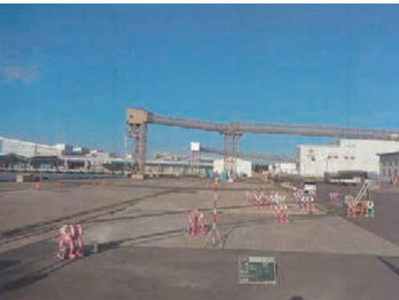
塩釜漁港 中ふ頭東棧橋背後防潮堤着手前
