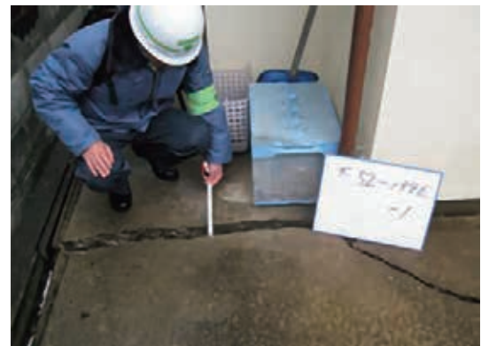
被災宅地危険度判定作業（仙台市）
