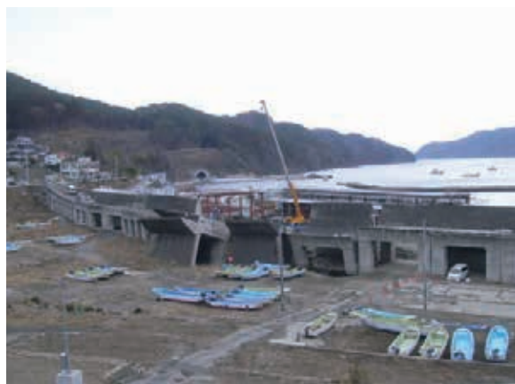
震災後の小白浜漁港防潮堤
