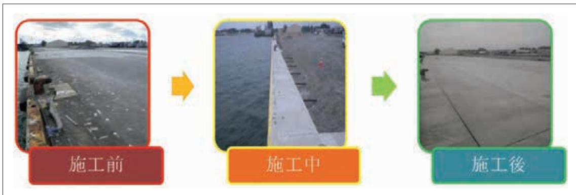
復旧前後の様子（相馬港 1 号埠頭岸壁）
