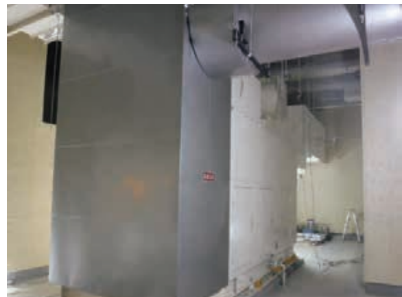
非常用発電設備
