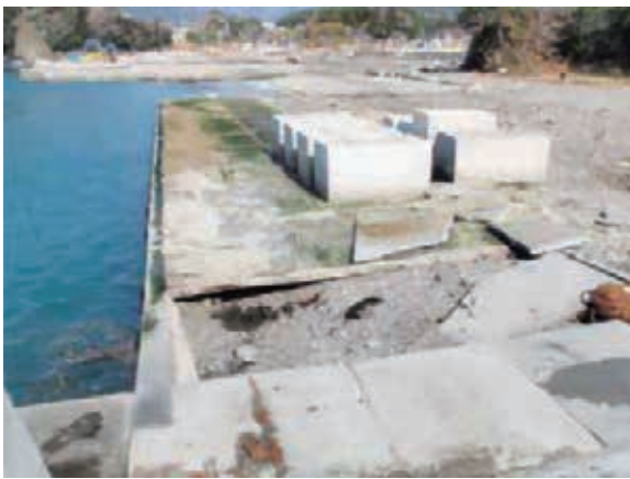
泊里漁港被災状況（平成 23 年 4 月）
