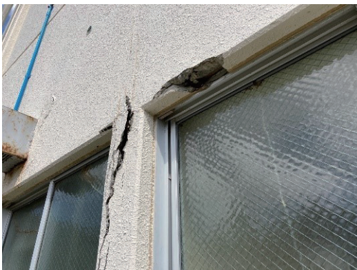
母島し尿処理場管理棟：外壁劣化部
