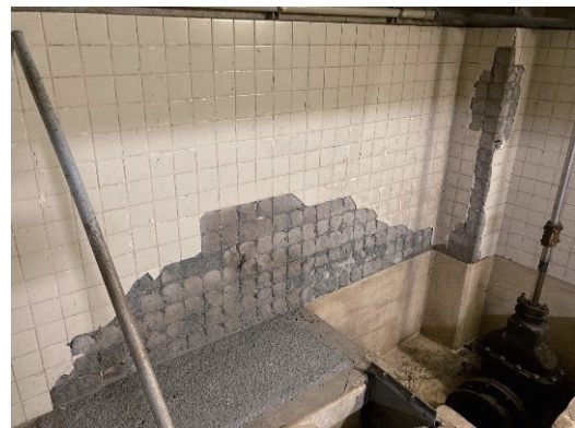
母島中継ポンプ場：ポンプ所劣化状況
