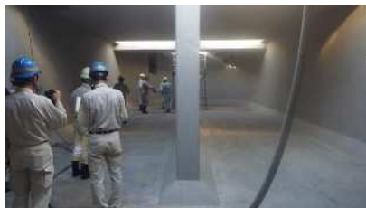
オキシデーションディッチ槽 内部
