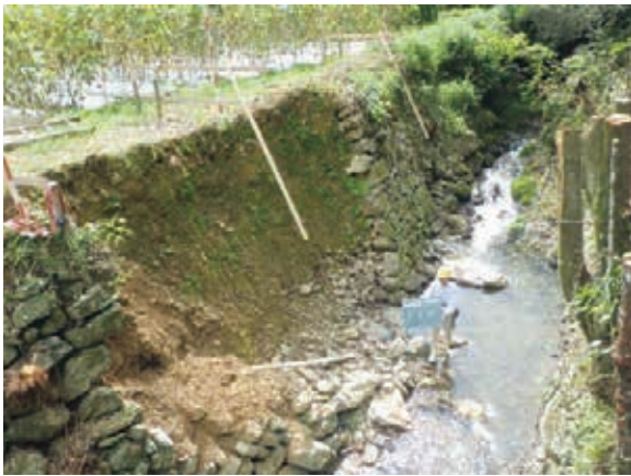
椽元川（復旧工事前）
