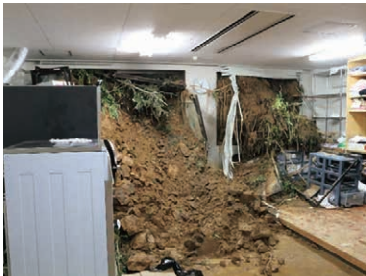
建物内部に土砂が侵入
