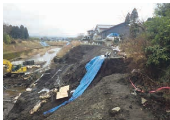
崩落した花原川の法面 (平成30年9月撮影)
