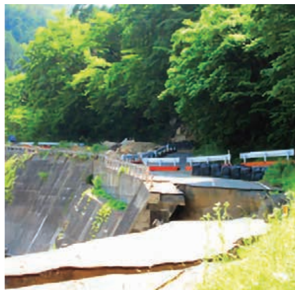
県道丸森霊山線道路災害現場（丸森町）
