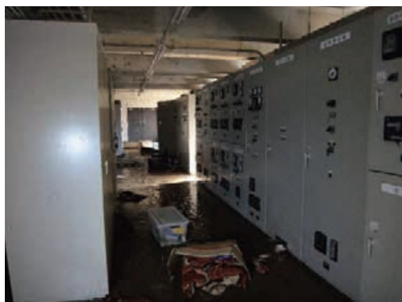
電気室（被災直後）
