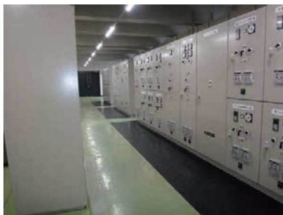
電気室（復旧後）
