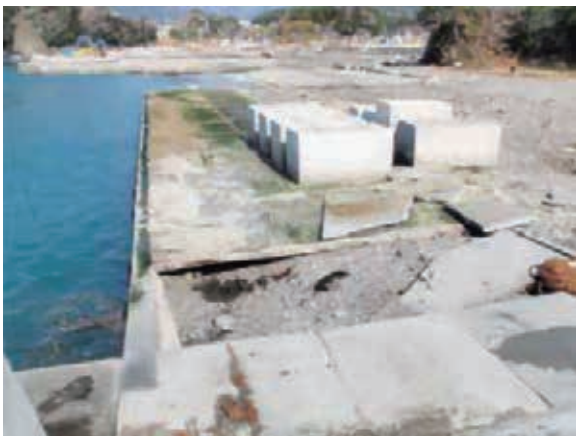
泊里漁港被災状況（平成 23 年 4 月）
