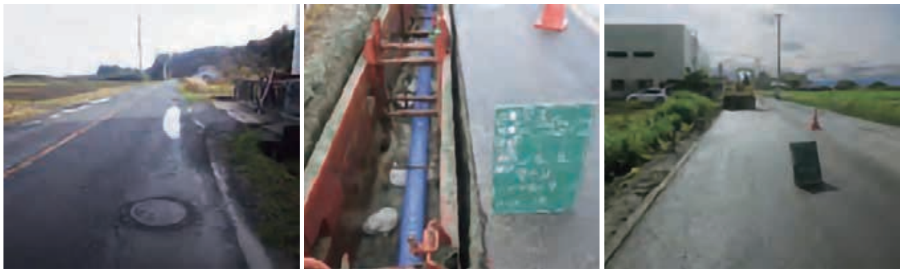
農業集落排水（下水道）復旧（左から着工前、管渠布設替え、工事完了）
