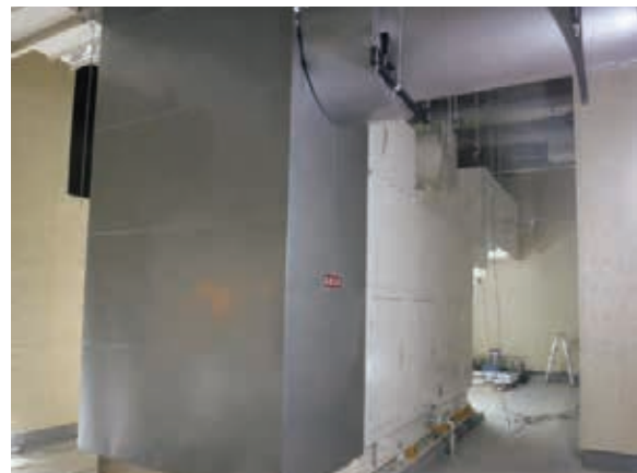
非常用発電設備
