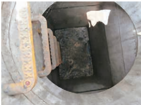
人孔B 汚水の滞水状況（平成 25 年 8 月 12 日撮影）
