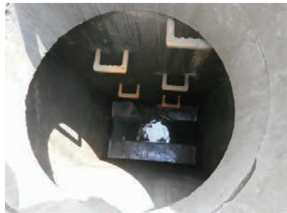
人孔A 汚水の流水状況（平成 25 年 8 月 12 日撮影）
