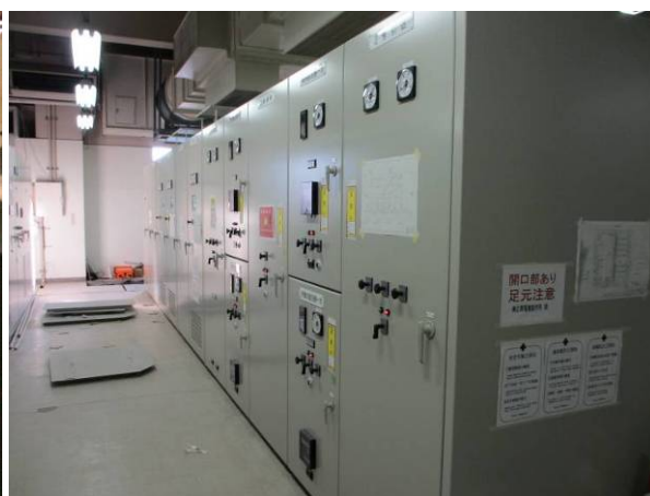
高圧配電盤（更新後）
