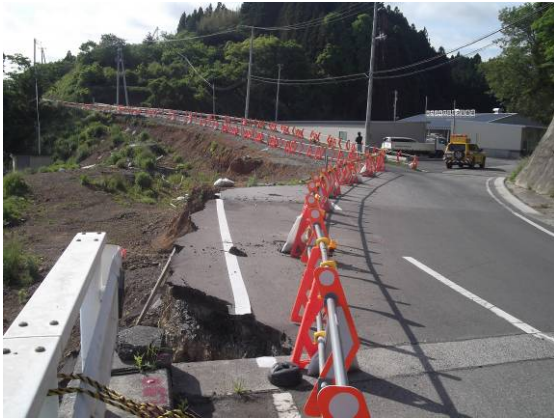
○津波による引き波によって壊れた道路
