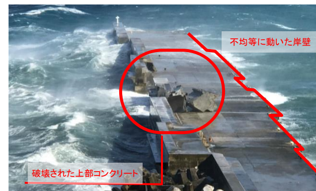
被災直後 平成30年10月1日撮影
