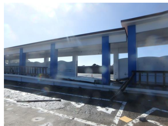
新島港ぬいねえどうの被災状況
