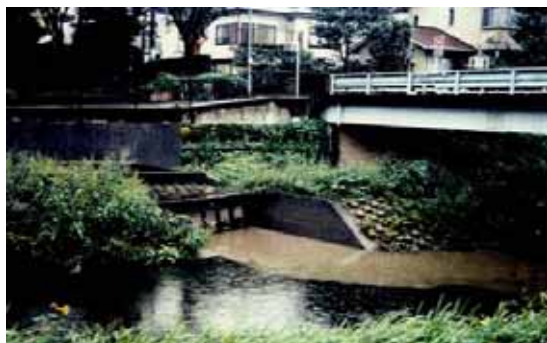
< 下水道管きよから雨水で希釈された汚水の一部が放流 >
