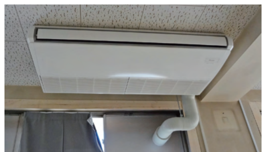
画像 18 教室書庫全室に設置した空調
